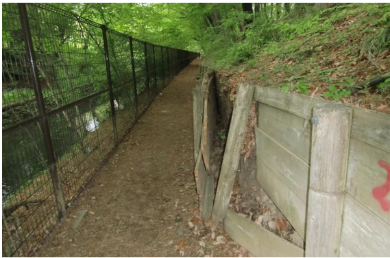
平成23年4月時点の遊歩道崩壊状況
